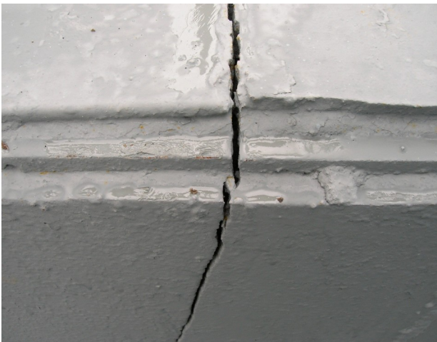
Рисунок 3 – Фрагменты разрушения металлооблицовки при пуске РН «Союз»
