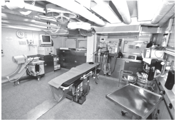
Рис. 1. Оборудование одной из операционных корабельного госпиталя
