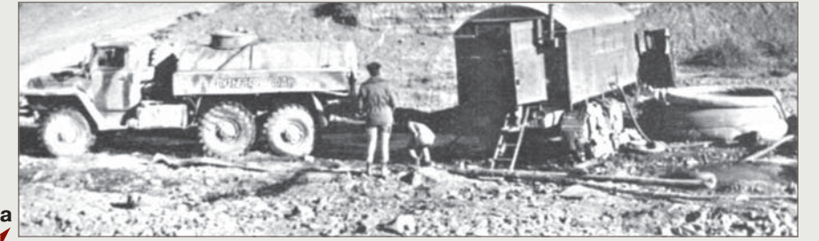
Автоцистерна принимает воду у фильтровальной станции
